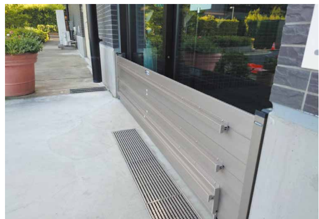
ゲリラ豪雨に備える止水板を設置
