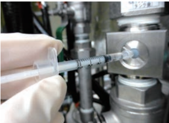
水処理装置の配管からもRO水を採取し水質検査を実施
