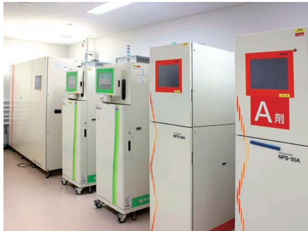
手前2台の機械がA剤溶解装置、一番奥が水処理装置、中央2台の機械が供給装置
